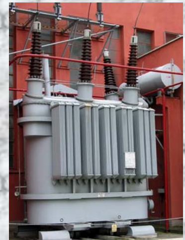
Transformator z 1942 r. pracujący w Rożnowie
